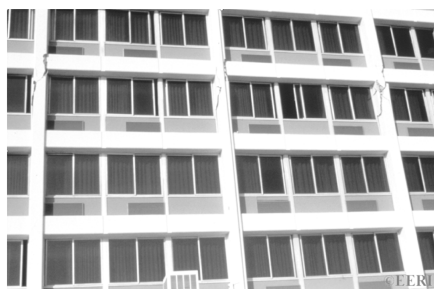
图 4 柱剪切破坏 Fig. 4 Shear failure of columns
