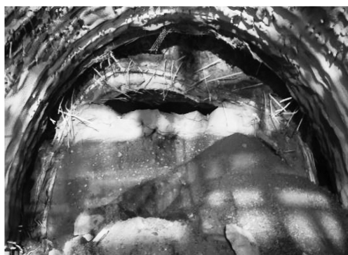
图 4 初支大变形侵限实景图
