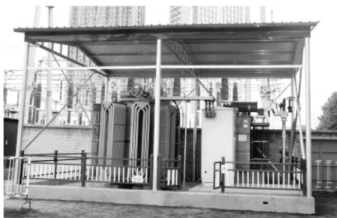
图2 变电所子系统实景图
