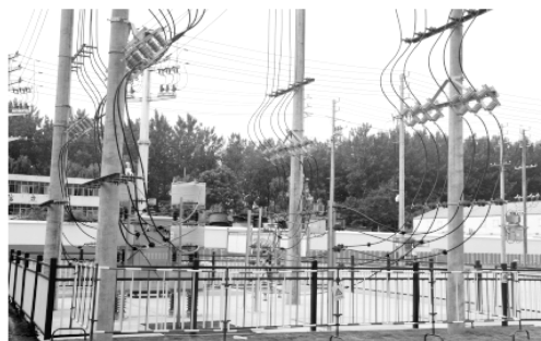
图4 故障模拟子系统实景图
